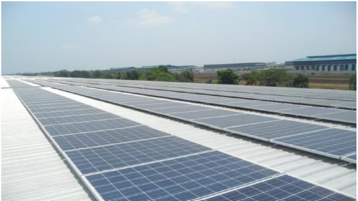
ตัวอย่างแผงเซลล์แสงอาทิตย์ (Solar Module)
