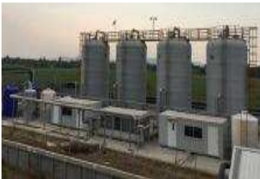
เครื่องไบโอสครับเบอร์ (Bio-Scrubber)
