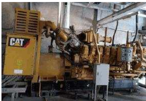
เครื่องกำเนิดไฟฟ้าของ Caterpillar
