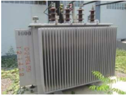
หม้อแปลงไฟฟ้า (Transformer)
