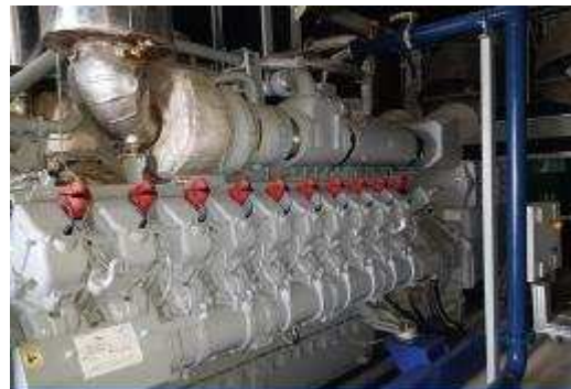
เครื่องกำเนิดไฟฟ้าของ MTU
