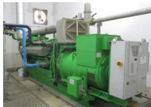
เครื่องกำเนิดไฟฟ้าของ Jenbacher
