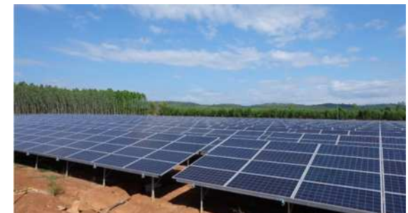
PSTE2 Solar farm 4.999 MW
