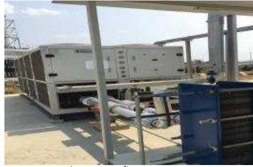
เครื่องลดความชื้น (De-Humidity)
