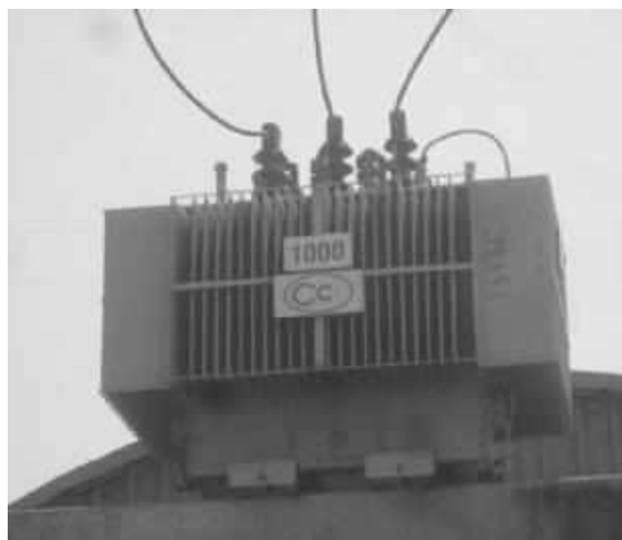
หม้อแปลงไฟฟ้า
