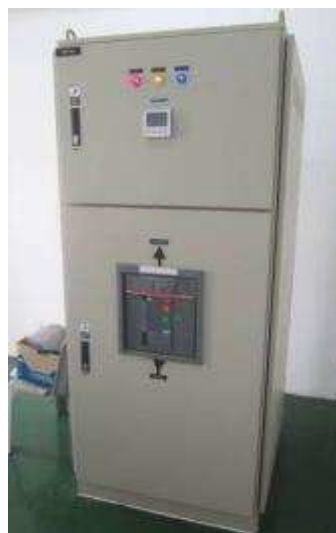
ตู้ควบคุมการรับจ่ายกระแสไฟฟ้า
