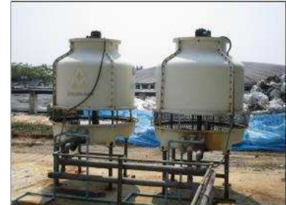
หอระบายความร้อน
